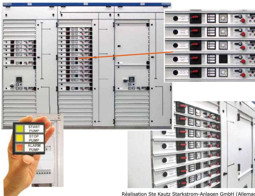
Réalisation Ste Kautz Starkstrom-Anlagen GmbH (Allemagne)
